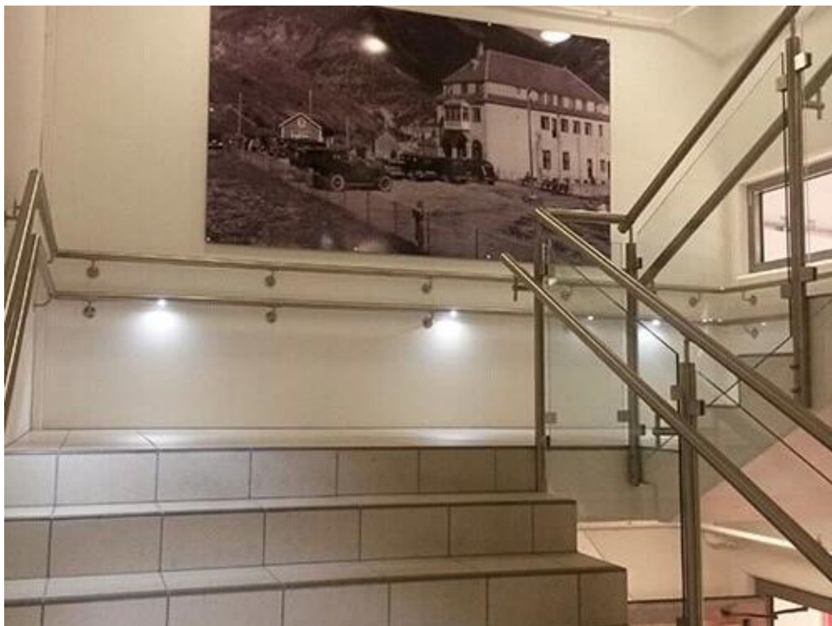
conector de tubo redondo utilizado en la escalera pasamano de acero inoxidable
