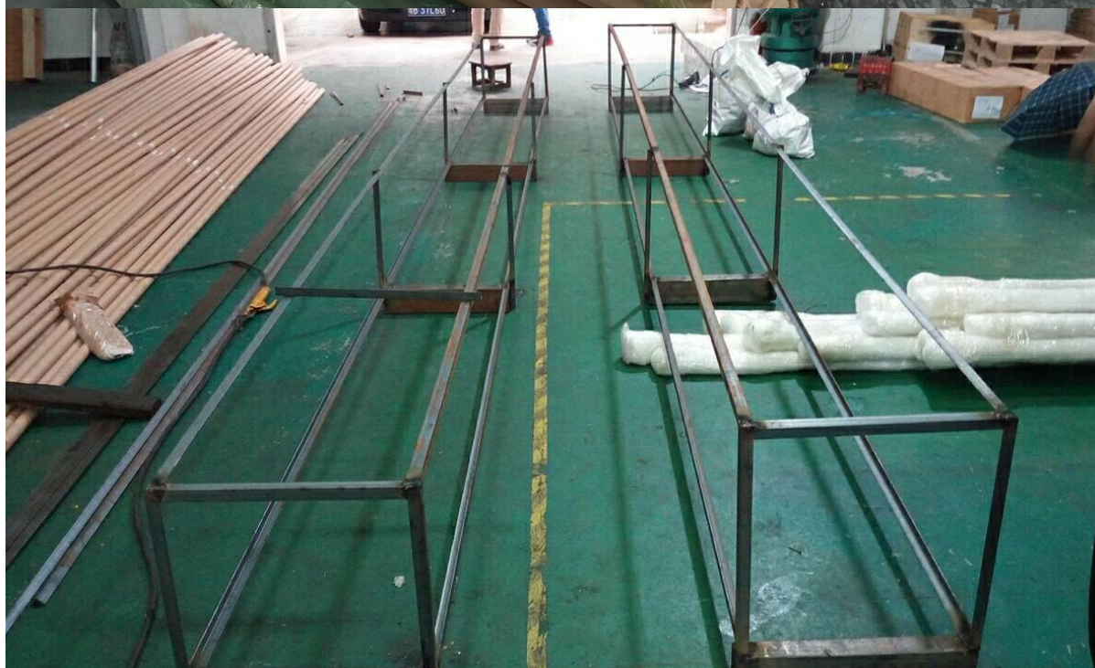
Foto di installazione di tubi di slot 20x25mm in acciaio inossidabile 316L per vetro da 12mm
