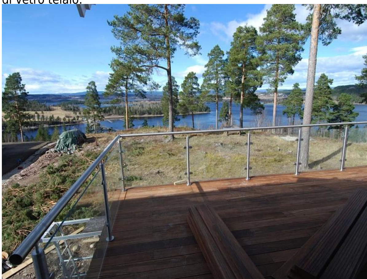
In fase di montaggio in acciaio inox; corrimano, si prega di fare riferimento a:
