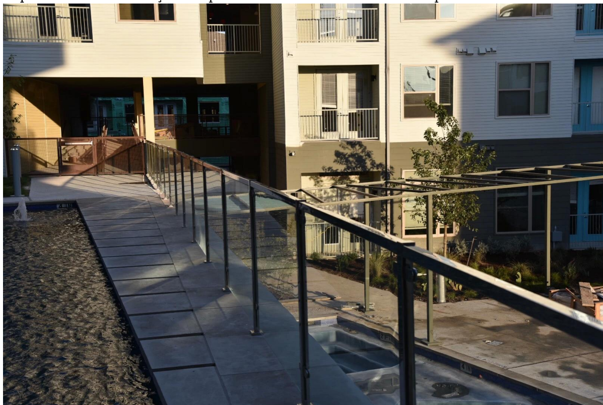
3. post de fotos instalação do quadrado 80x80mm inox com tampa de extremidade selada
